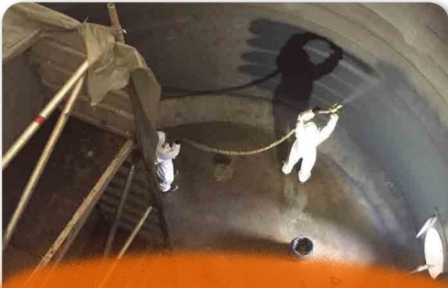
Silos und Behälter
